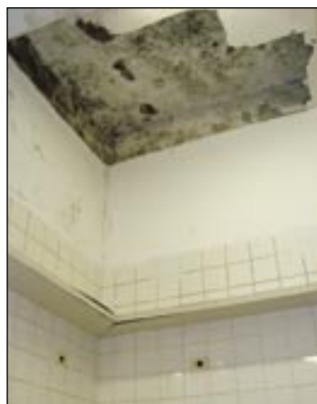
... e infiltrações com desabamento de teto em diversos locais
